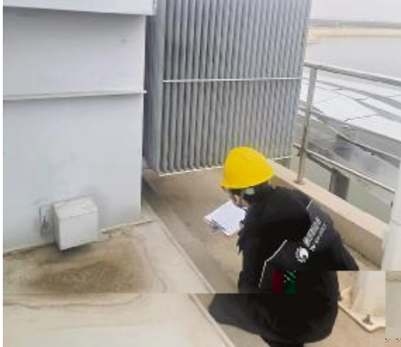
运维工作人员查看设备运行情况
